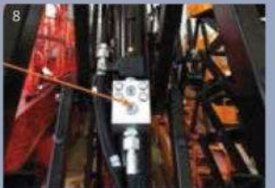
8 วาล์วกันระเบิด: เพื่อป้องกันไม่ให้เครื่องจักรล้มลงเมื่อท่อน้ำมันรั่ว
